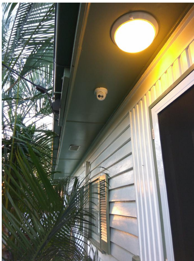
Figura 3 - Ejemplo de una cámara instalada
